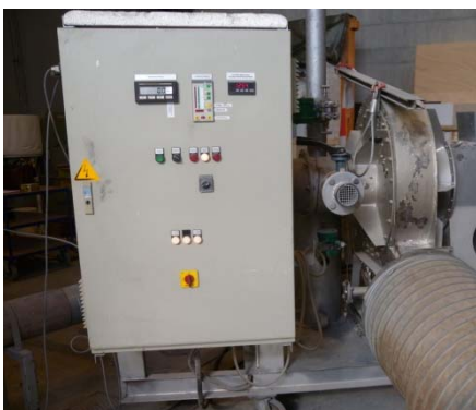
Ventilator-System zur Erzeugung des Volumenstroms
