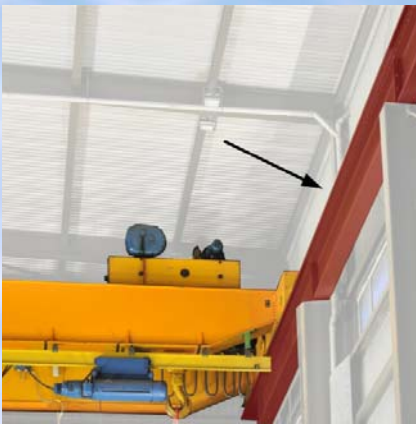
Krananlage in einer Maschinenhalle
