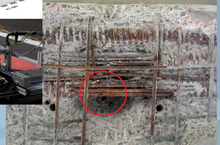
Geöffnetes Hüllrohr mit Spannstahlbruch in einer Spannbetonbrücke
