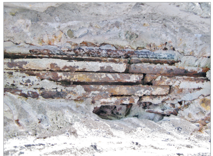
Abbildung 1: Beispiel eines Spannstahlbruchs infolge Spannungsrisskorrosion, der mit der magnetischen Streufeldmessung gefunden wurde
